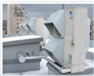
▲屋上の室外ユニット
