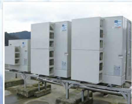
▲屋上に設置された室外ユニット
