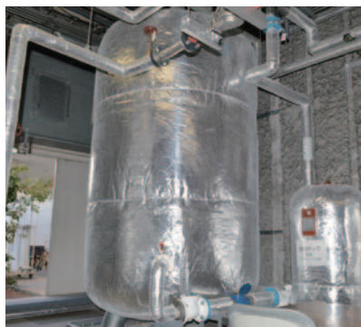
▲厨房給湯用密閉タンク7tの貯湯槽
