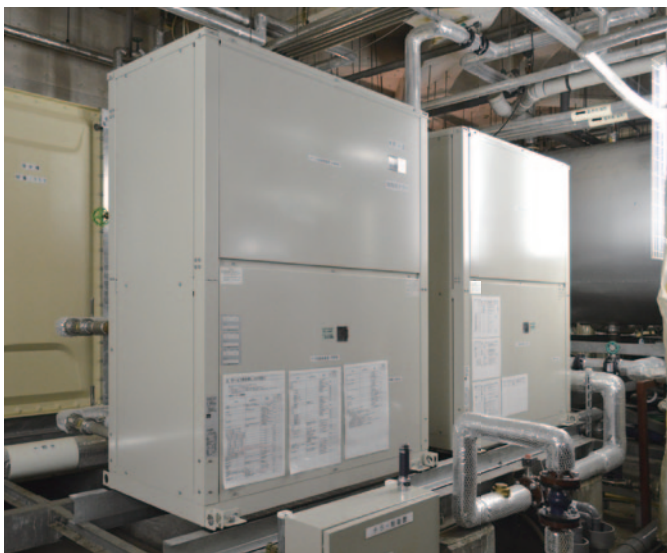
▲今回ご採用いただいた2台の水熱源ヒートポンプ(浴室給湯用)。温泉施設の排熱を有効活用し、ランニングコストを大幅削減。
