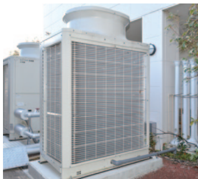
▲レストランの厨房に業務用エコキュートを採用
