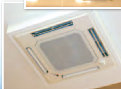
▲高天井にきれいに設置された フィルター自動清掃ユニット付室内ユニット
