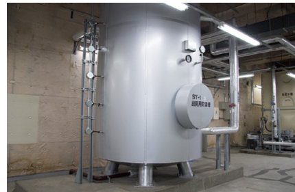
▲厨房用の密閉型貯湯槽(6トン)
