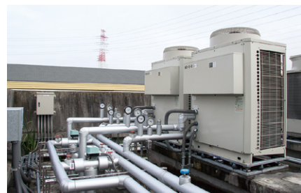
▲厨房用の業務用エコキュートQAHV-N560C-HWP×2
