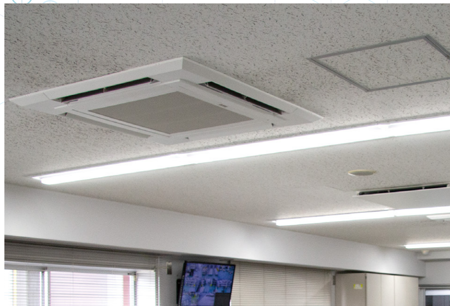
▲営業時間は8:30~17:30。女性スタッフによると、コロナ対策の換気(1回/h)が無ければ、空調更新後は電気ストーブが不要になるくらい暖かいとのこと
