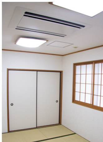
▲男子休憩室は天井カセット形(2方向吹出)を採用
