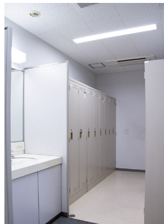
▲男子更衣室の室内ユニットは天井カセット形(1方向吹出)を採用
