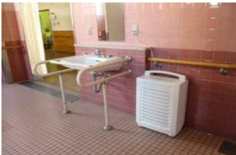
▲2階のトイレの手洗いの横に設置してみました
