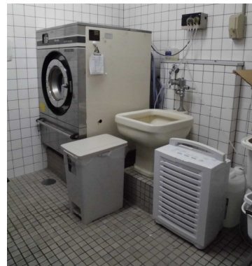
▲1階から3階の各汚物処理室にデオダッシュを設置したところ、臭いも気にならなくなり大好評。
