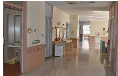
↑ 2階ユニット「しのぶ」のトイレ入口に設置された脱臭機。トイレの臭いが廊下に漏れなくなり入居者、ご来客者の皆様に喜ばれています。
