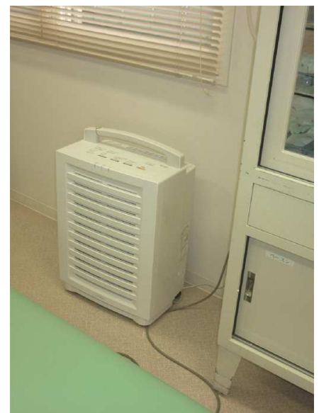
形成外科 処置室 設置状況
