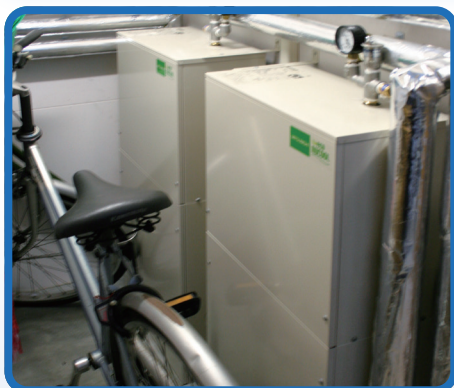
熱交換ユニット + ヘッダー
