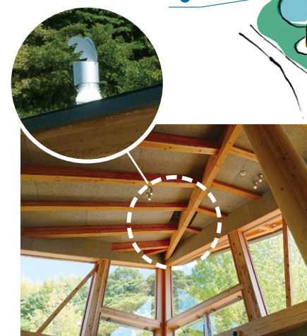
◀屋根にウインドカウルを設け、棟内の空気を圧力差によって排出する自然換気を採用
