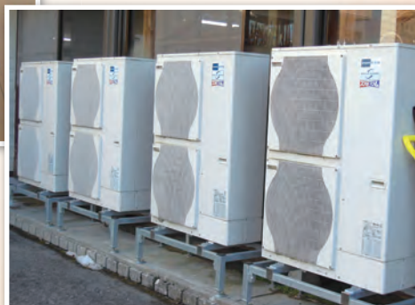
▼室外ユニット
