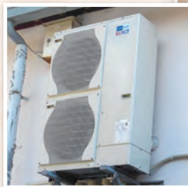
▼壁面に設置された 室外ユニット
