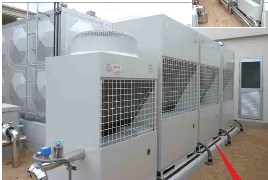
▲入替後の業務用エコキュートと貯湯槽(呼称30m³)(手前の1台は水風呂冷却用の空冷チラーMCAV-P224A)
