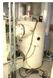
▲更新前の灯油焚きボイラー(業務用エコキュート導入後もバックアップ用に残してある)
