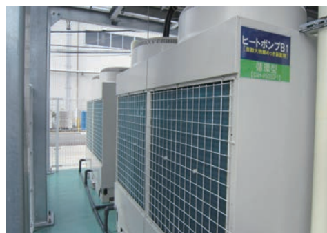
◀工場脇に集約設置されたホットウォーターヒートポンプ CAHV-P500AK-H-BS×1台(左) CAH-P500CP1-BS×2台(上)
