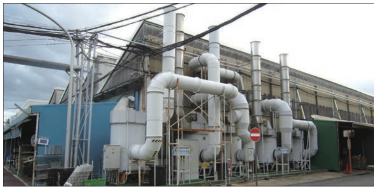
▲めっき工場の外観。真空減圧温水加熱による污泥(スラッジ)乾燥や、スチームトラップの診断など、さまざまな方法でCO 2 削減に取り組んでいる
