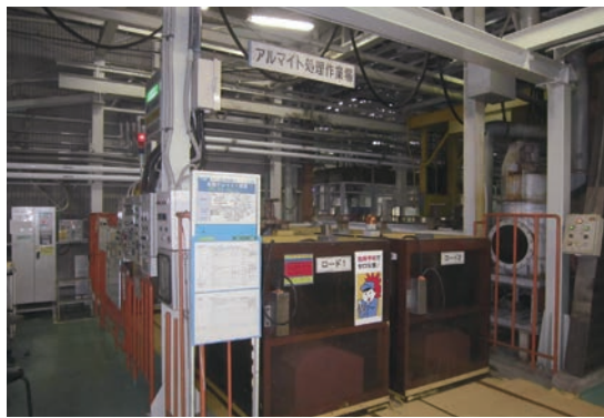
▲自動アルマイト処理ライン。湯洗槽の熱回収を行い、ロスの削減に努めている
