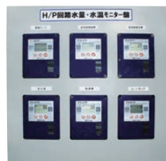
▲ヒートポンプ回路水量・ 水温モニター制御盤。
