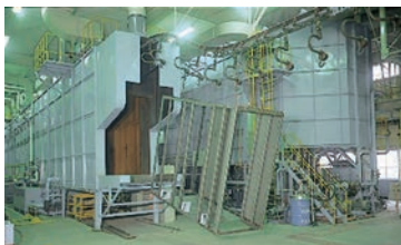
◀既存の蒸気設備と、ホットウォーターヒートポンプが併用されている電着塗装ライン。
