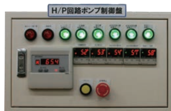
▲ヒートポンプ回路制御盤。 リモコン(RP-16CB)で制御。
