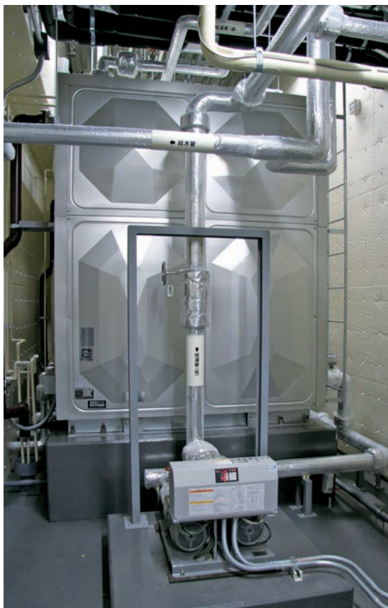
▲貯湯タンクは放熱と防虫対策のため機械室内に設置。タンク内は中仕切によって2槽化しているが、連通管で接続
