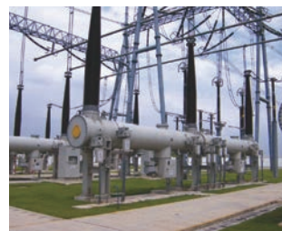
▲GIS(ガス絶縁開閉装置) 550 kV GIS
