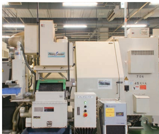
▲切削加工機の切削液冷却機(冷水利用側)
