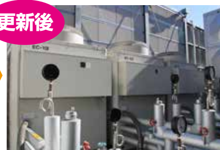
▲1台のボイラーから5台の業務用エコキュートに更新
