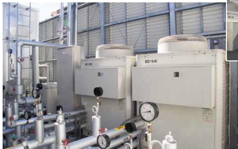
▲騒音対策のため、囲いの中に設置された業務用エコキュート
