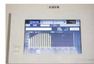
▲貯湯量や貯湯温度などは、集中コントローラで監視管理
