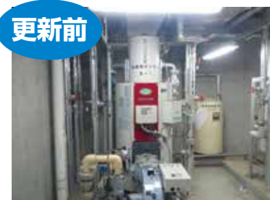
▲機械室に設置していた既設ボイラー
