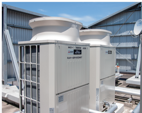
▲補助金が採択されたので高効率機種グランマルチを導入
