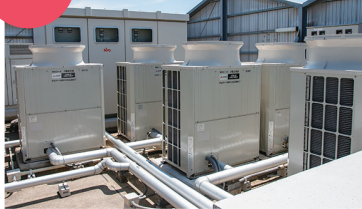
▲更新後の室外ユニットも屋上に集中設置
