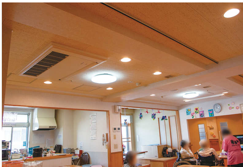
▲食堂・娛樂室・居間からなる「多目的ルーム」。室内ユニットは食堂・娛樂室・居間に各1台
