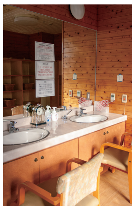
▲脱衣所にある洗面台への給湯も同じ系統で賄う
