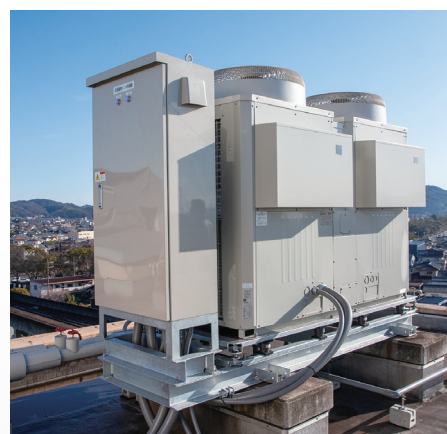
▲屋上に設置された更新後の熱源機、ホットウォーターヒートポンプ
