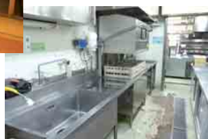
▲厨房の食洗機にも給湯
