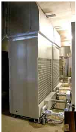
▲地下室に設置された業務用エコキュート
