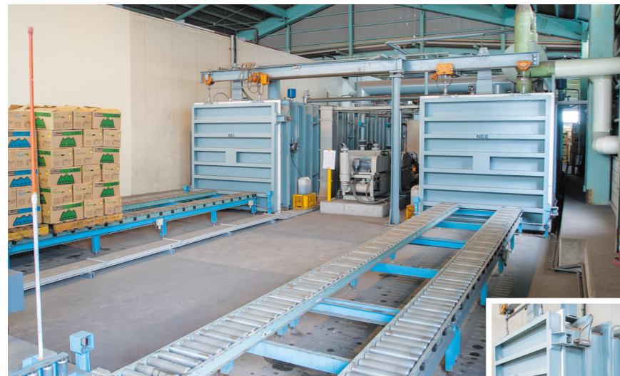
▲コンベアを備えたトンネル式の真空予冷設備が2ライン
