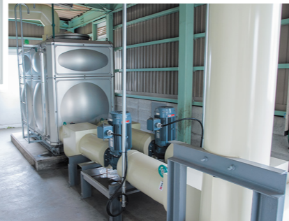
▲機械室のブラインタンクとポンプ。ブラインタンクは3m、ブラインポンプはライン型(ブライン仕様)2基
