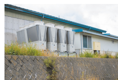
▲ブラインクーラはコンパクト性を活かし、クーリングタワー撤去後のスペースに設置。右側が機械室
