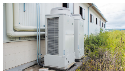
▲予冷庫用のインバータコンデンシングユニットECO V-EN110MB×2
