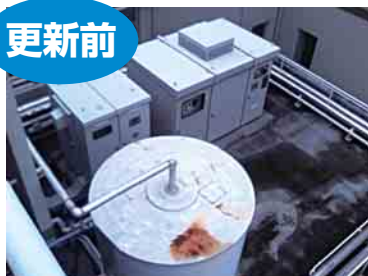
▲更新前のヒーター式電気温水器(8,400L)
