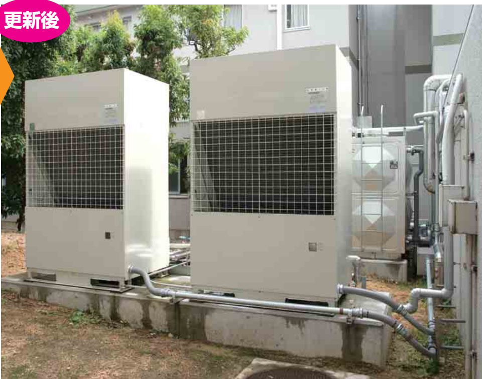
▲2008年3月に設置された業務用エコキュート。三菱電機と関西電力・東京電力の3社共同開発品
