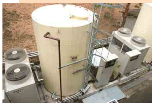
▲2007年に導入された三菱電機のヒートポンプ給湯機「サニーパックQ」(20馬力×2台)。貯湯槽は8m 2 ×2基
