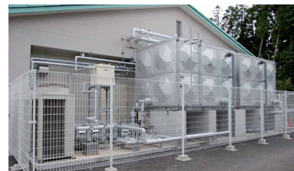
▲開放型(呼称12トン)貯湯槽2基と温泉昇温用のチラー。建物の東側妻部に集約設置された
