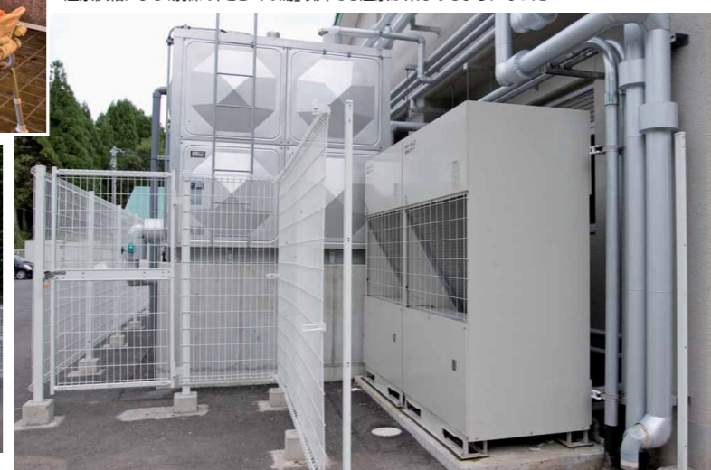
▲貯湯槽の逆側には地下水昇温用のサニバックQ ECOが2台ある
