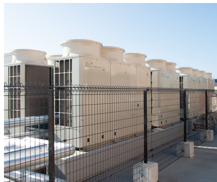
▲インバータコンデンシングユニット(R410A)は屋上に 集中設置
