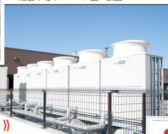
▼外調機の室外ユニットはシティマルチ。 3階駐車場のスロープ脇に設置
