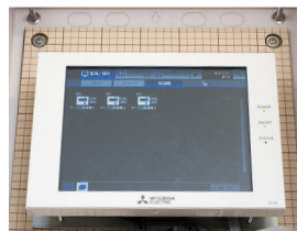
▲2階の事務所にAE-200Jを設置
