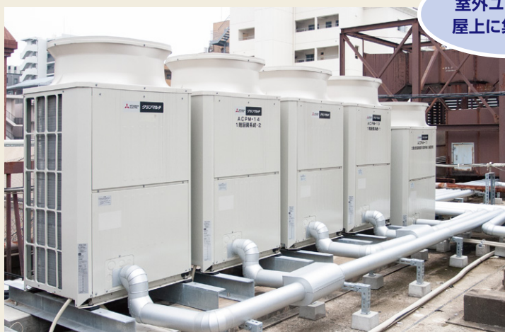
▲室外ユニットは屋上に分散設置。空冷チラー撤去後のスペースも活用
