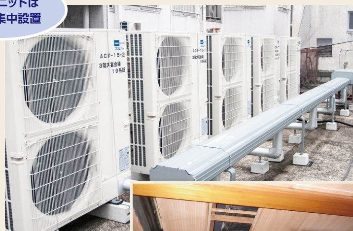
▲3階の大広間の室外ユニット
