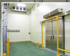
▲冷凍庫の出入口にはエアーカーテンを設置
