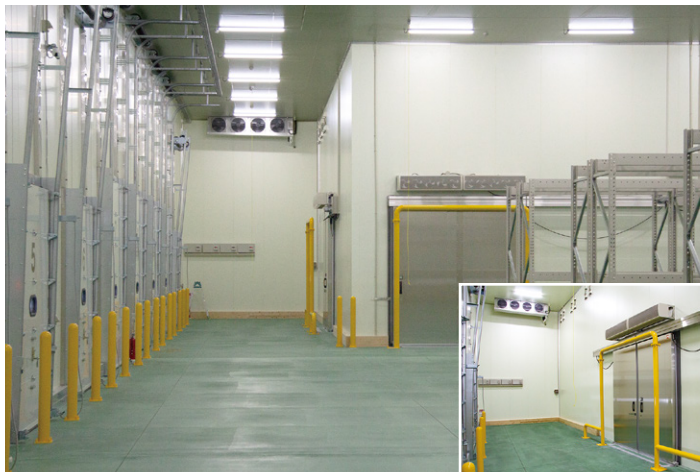
▲天井高が6メートルを超えると、建築基準法にて特定天井と判断されることもあり、天井の脱落防止措置などが必要となるため、天井高は6メートル以下に抑えつつ庫内容量を最大限確保した
