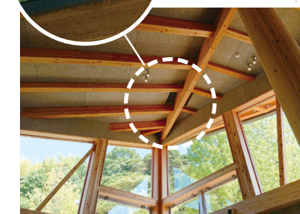
◀屋根にウインドカウルを設け、棟内の空気を圧力差によって排出する自然換気を採用
