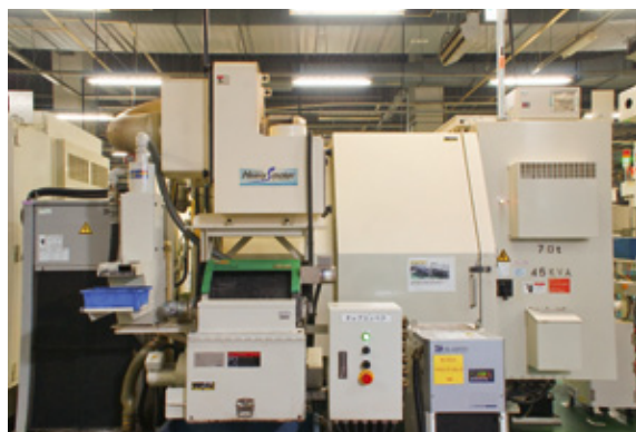
切削加工機の切削液冷却機(冷水利用側)
