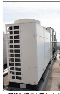
▲既設熱源機と同タイプの低温循環型冷水装置
