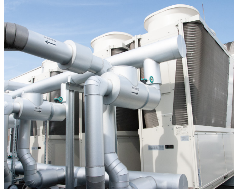
▲プロセス冷却用熱源機を一体空冷式インバータブラインクーラBALV-EN50A-P形(50馬力・ポンプ内蔵タイプ)6台に更新。既設は一定速機30馬力×9台だった
