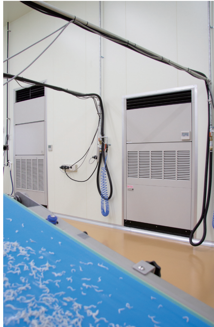
▲産業用除湿機(インバータタイプ)を使って、洗浄後のしらす選別機を乾燥させている。設定湿度は45%
