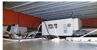
◀一階と二階の天井裏には0.8馬力の天吊形除湿機を各1台設置。これは二階用
