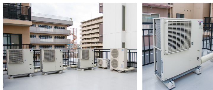
▲コンデンスユニットは屋上に集中設置
