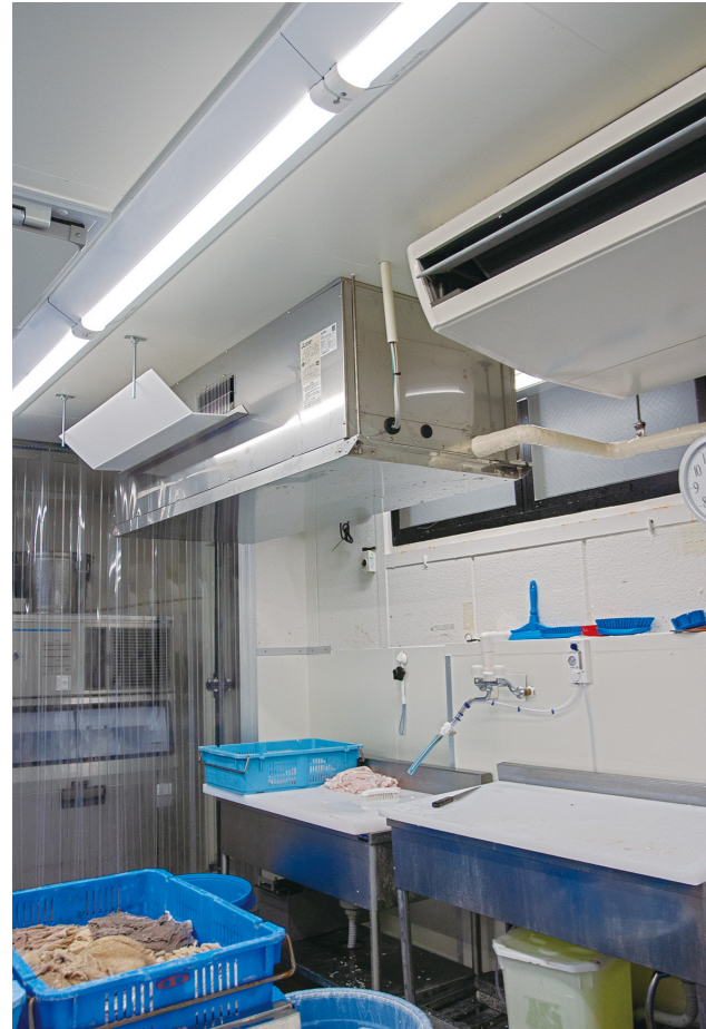
▲一階加工場、中温用パッケージエアコンの隣に設置された2馬力の天吊形産業用除湿機。塩素が多い雰囲気なので外装ステンレス仕様+防食仕様(カチオン電着塗装)を採用
