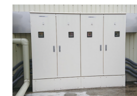
▲コンデンシングユニットの動力盤は筐体間に設置
