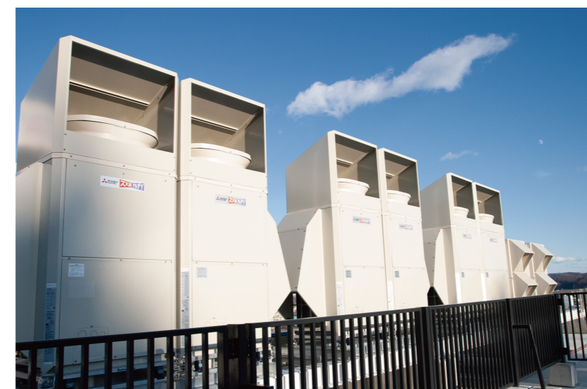
▲ズバ暖マルチYとズバ暖スリムの室外ユニットは屋上に集中設置。防雪フードや防振架台は株式会社ヤブシタ様製
