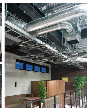
▲アトリウム脇にあるソファコーナー。天井は張らず「配管見し」で機器の吊りこみ具合を見せる
