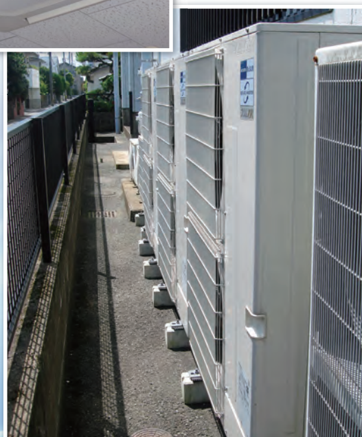
室外ユニット▶
