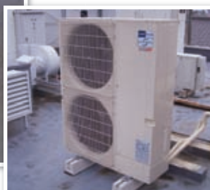
▼室外ユニット
