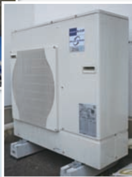
▼室外ユニット
