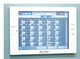
▲事務所にあるAE-200Jのコントローラ。天井裏除湿機用に、制御盤内にも1基設置されている
