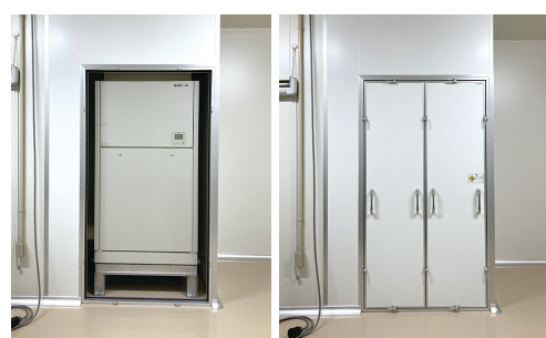
▲設備用パッケージエアコンは壁面に収納
