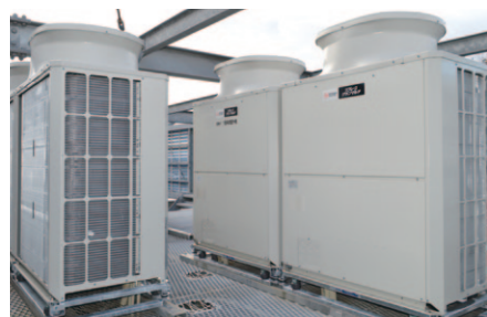
▲室外ユニットはリプレースグランマルチをご採用
