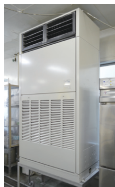
◀作業エリアの空調用途に使用
