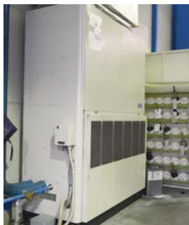
▲室内ユニット(ズバ暖設備用PAC)
