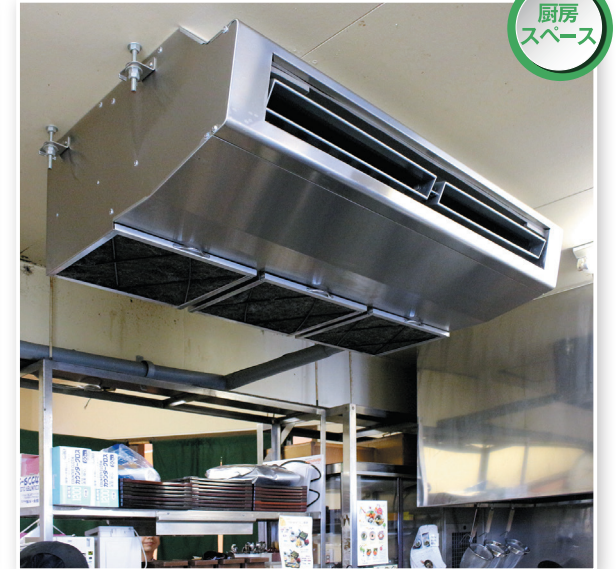
▲厨房用天吊形で厨房の環境も大幅に改善されました！
