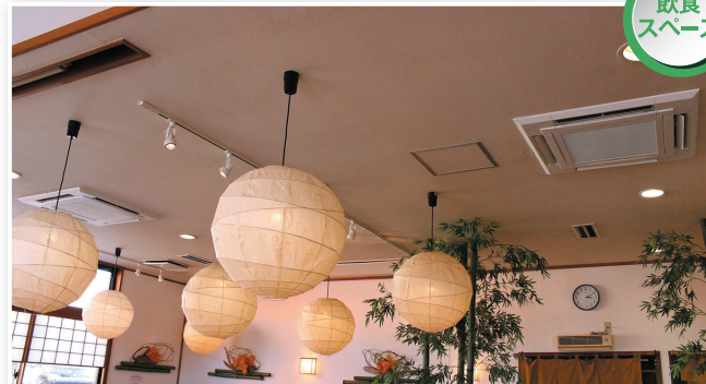
▲飲食スペースには4方向カセット形を設置。
