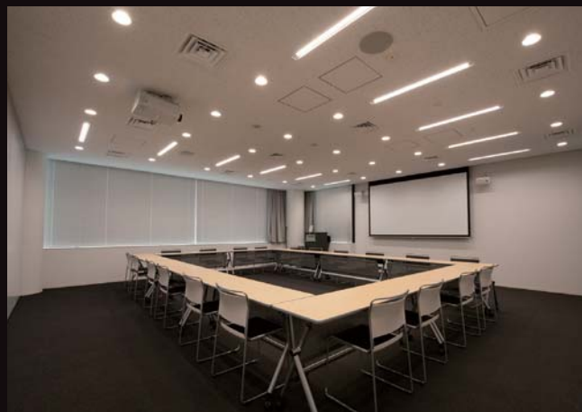
会議室 LEDダウンライトとLED埋込形スリム器具による構成とし、必要照度750lxを確保しています。
