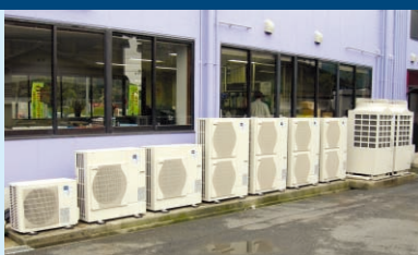
室外ユニット
