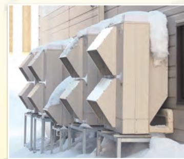
▲室外ユニット
