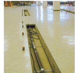
店舗内は地中(ピット)内で配管が導かれショーケースへ接続される
