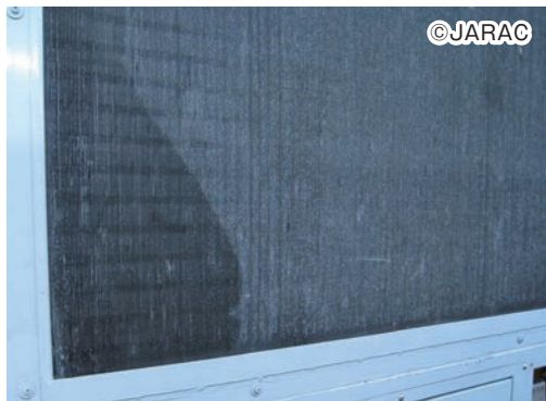
室外ユニット 油にじみ例
