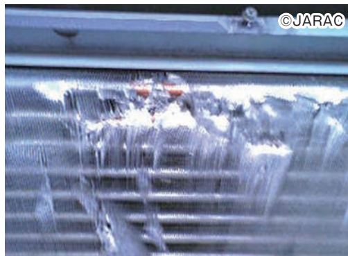
室外ユニット 熱交換器表面の損傷例
