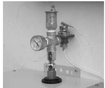
◆圧力計・空気抜き弁・安全弁
