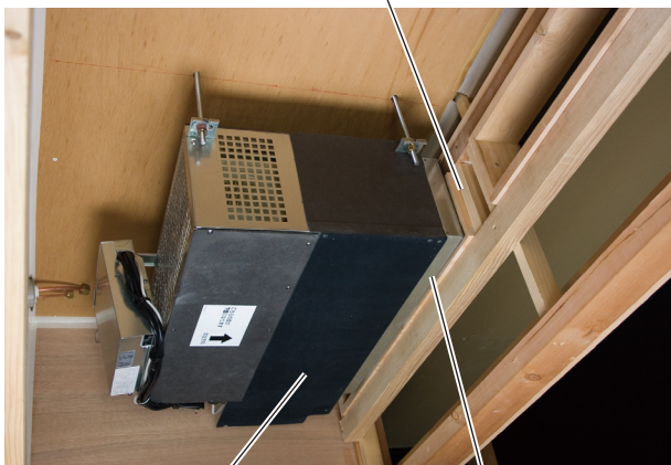
室内ユニット
