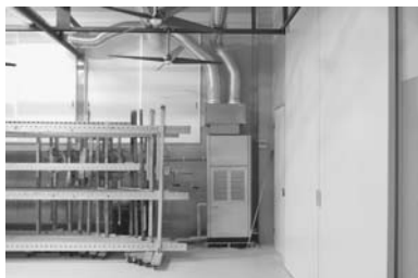
▲この産業用除湿機は2007年5月に設置されたもの
