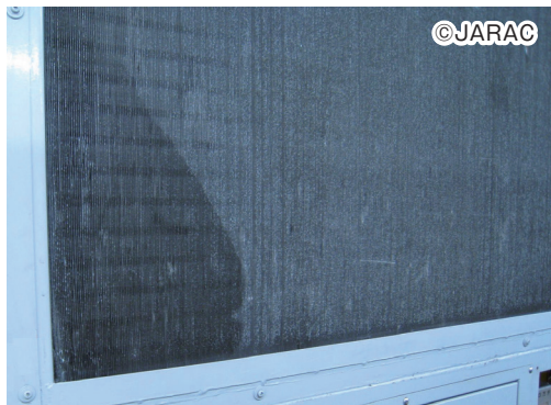
室外ユニット 油にじみ例
