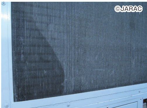
室外ユニット 油にじみ例
