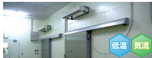
原料冷凍庫の扉上部に設置されたエアー搬送ファンで庫内の冷気を保護
