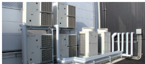
▲コンデンシングユニットは運転効率とメンテナンス性を考慮して、一部は 地上設置とした
