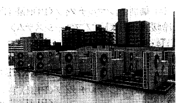
▲屋上に据えられた室外ユニット
